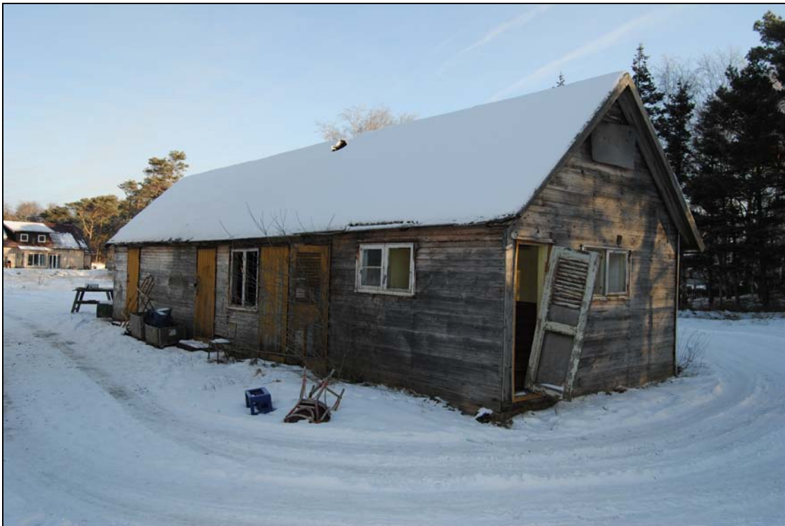
Den förfallna förrådsbyggnaden öster om Strandhotellet.
