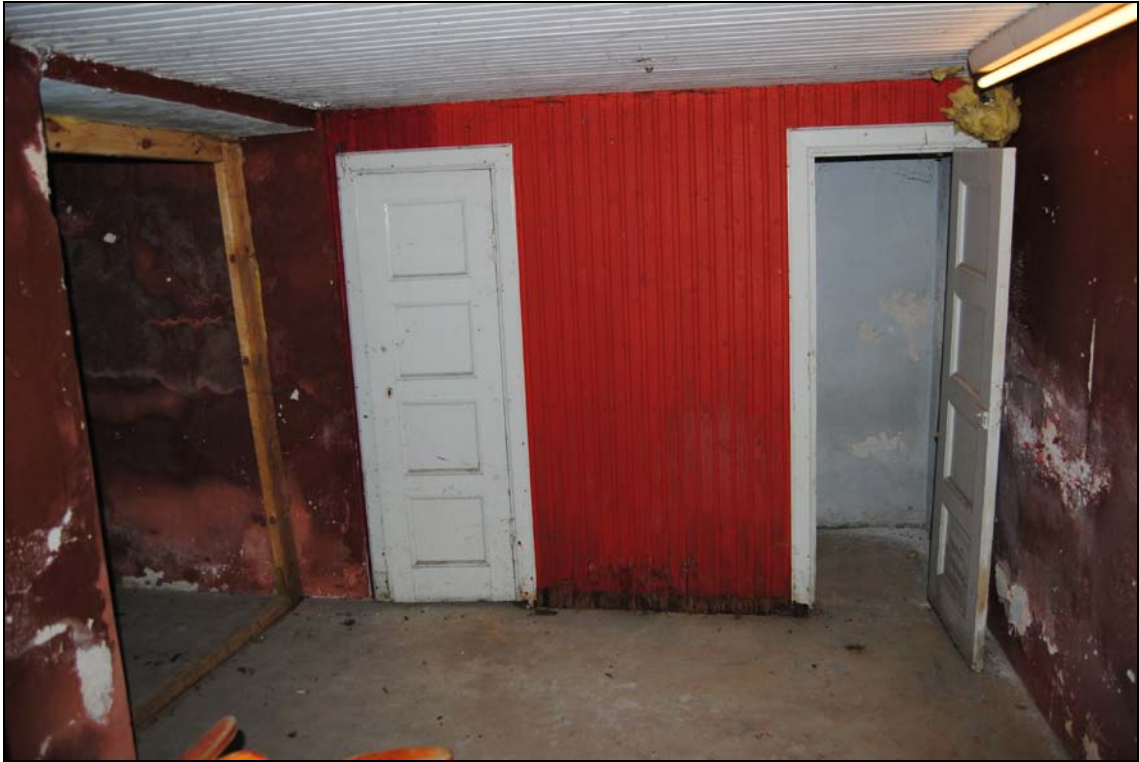
Strandhotellet, interiörer, jan 2010. Ställvisa fuktskador förekommer i källarvåningen.
