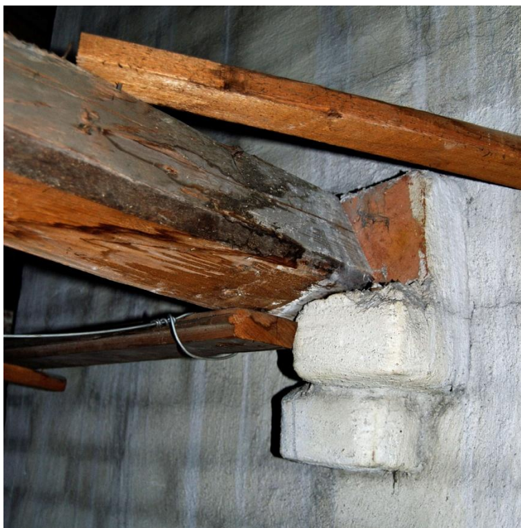
Bjälkupplag på murstock. Bjälken har torkat och kommit ur läge.
