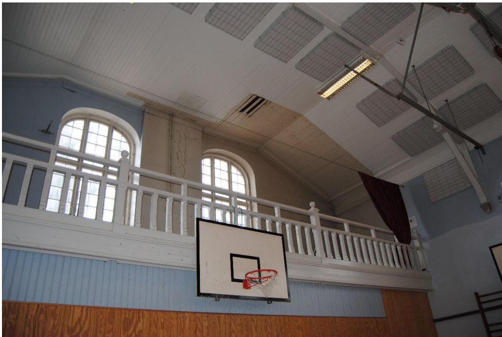
Läktaren sedd från bottenplan. I mitten syns fuktskadorna vid tak och skorstensstock.
