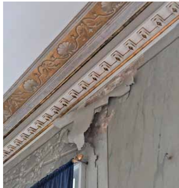
Den målade tapeten i matsalen hade lossnat från underlaget på grund av en fuktskada i ytterväggen.
