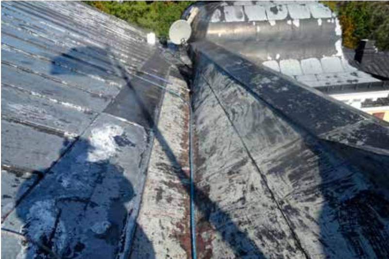
Plåttaket före renovering. Färgen hade helt släppts från underlaget på stora ytor. Vissa av fotplåtarna var genomrostade. Begynnande korrosion fanns på flera ställen. Foton Leif Johansson, Renovator AB.
