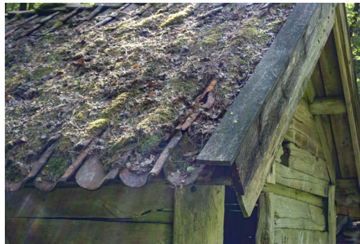
Taket är överväxt med mossa och nedfallna löv, några pannor är trasiga.
