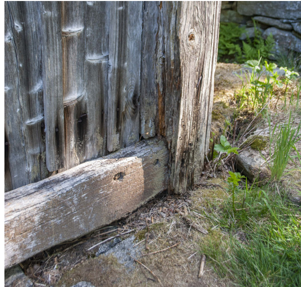
Rötskadad stolpe vid dörren.
