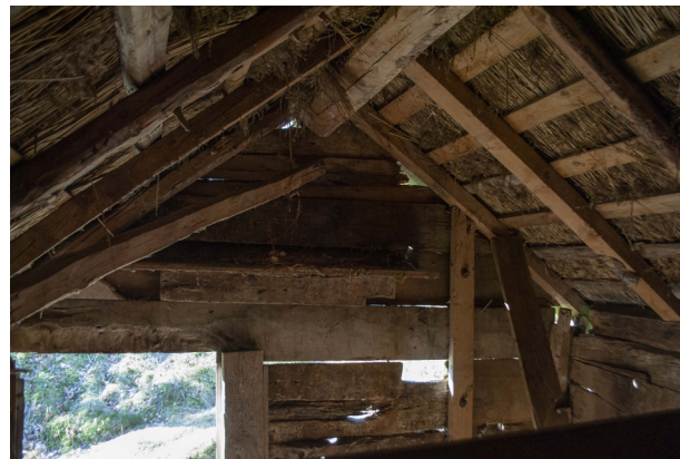
Bållarna i gavelröset har också rötskador.
