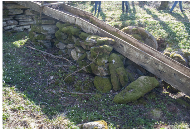
Murverket har delvis rasat och trärännen har knäckts.
