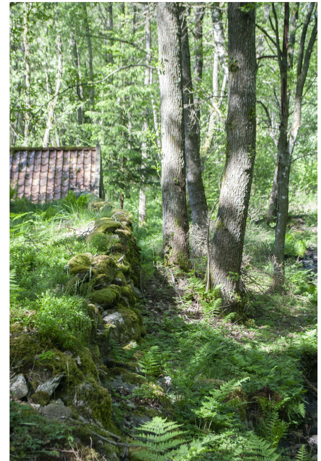
Dessa träd och dess rötter intill stenkanalen kan på sikt skada murverket.
