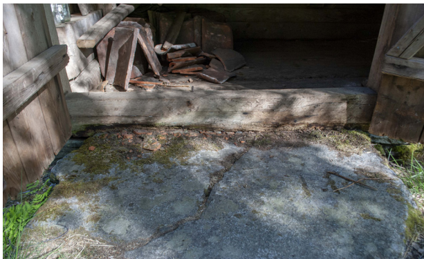
Det samlas lätt löv, växter och skräp vid trösklen som kan ge upphov till fukt.
