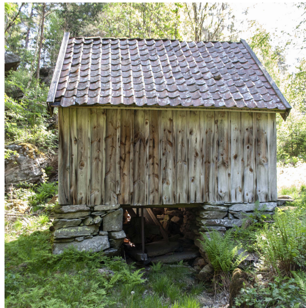
Några tegelpannor är trasiga och ligger lite snett.
