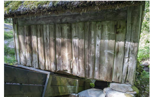
Panelen är rötskadad i nederkant där rännan leder in vattnet under huset.
