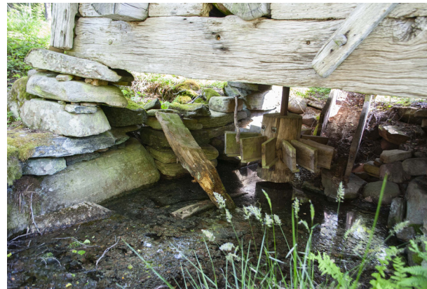
Det står vatten under kvarnen och grundstocken har lossnat och är mycket rötskadad.
