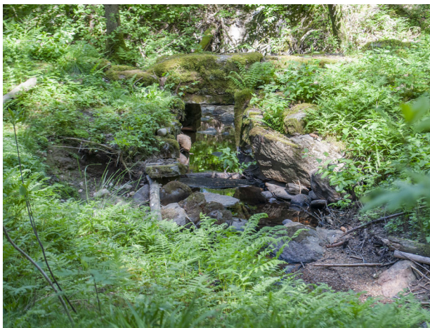
Överst: Det står vatten under kvarnen. Bro vid dämnet uppströms kvarn 11.
