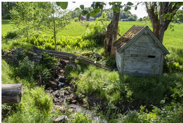
Överst: Kvarn 15 flankeras av två höga askar, varav en har skadats i en storm. Nederst: Bäckens tar en rund sväng runt kvarnen, under trärännan vilken skadats av askens nedfallande stam.
