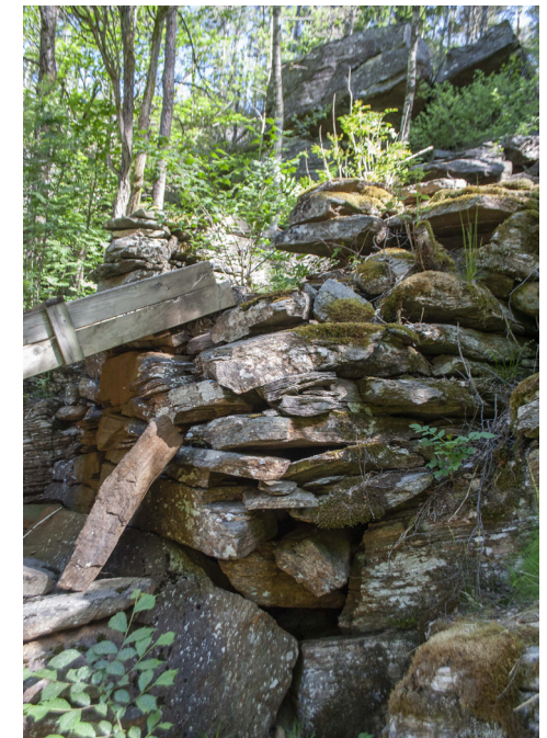
Bjälken på vilken trärännan vilar har ytliga rötskador. Stenar har ramlat ur murarna som bär upp rännen.
