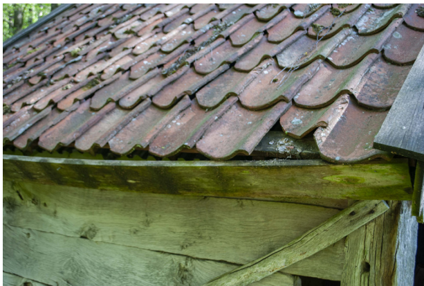
Brädan i takets nerkant bågnar och några takpannor är trasiga.
