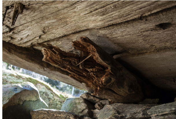
Rötskadad bjälke under golvet i kvarn 2.
