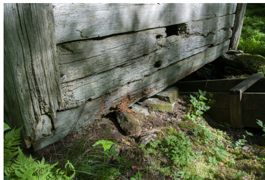
Syllen mot rännan är rötskadad.
