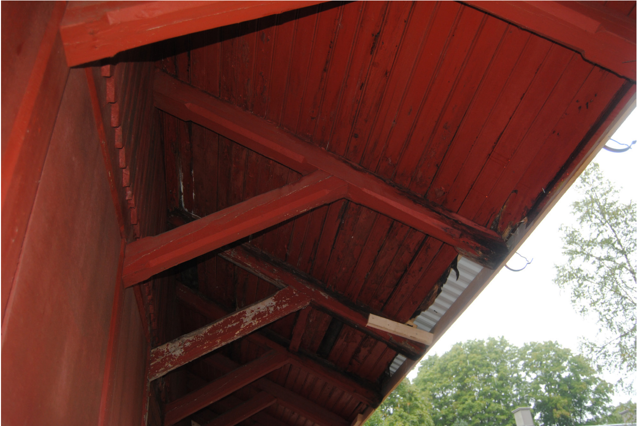
Takfoten mot norr har rötskador.
