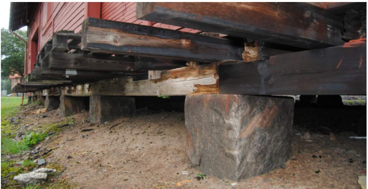
Skador i syllstocken mot spårsidan, orsakade bl.a. av att lastbryggan saknas.
