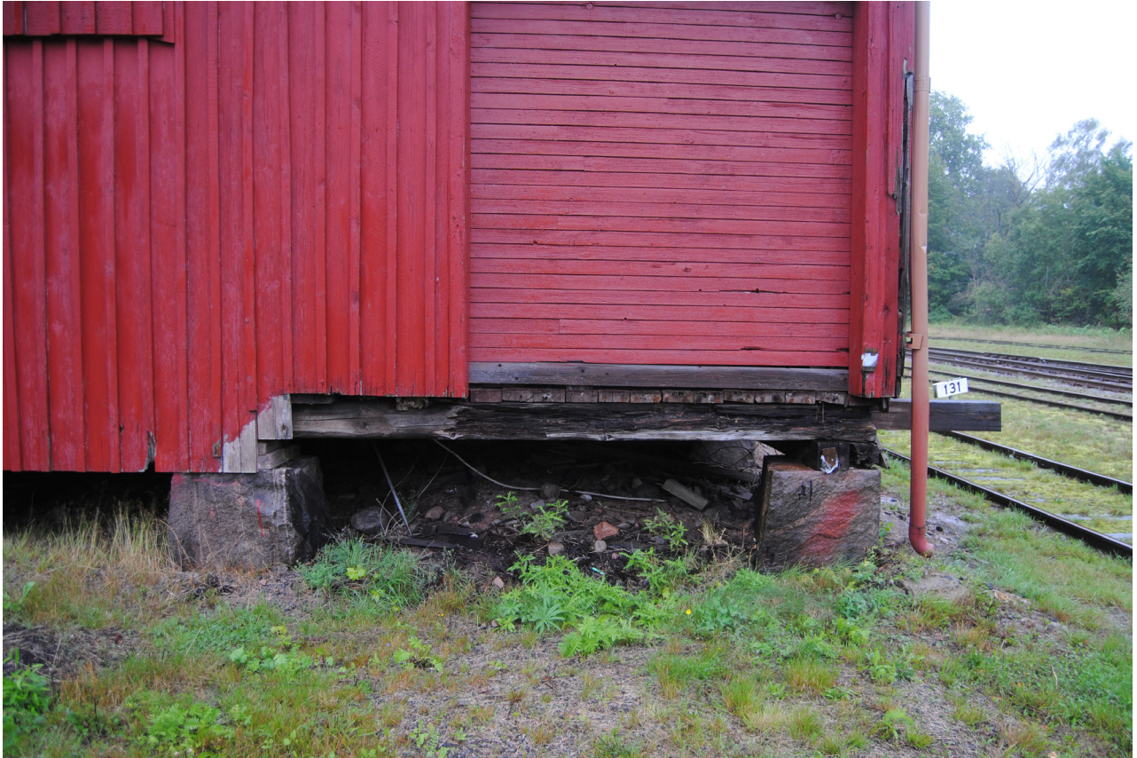
Exponerad syll på östra gaveln som fått rötskador.
