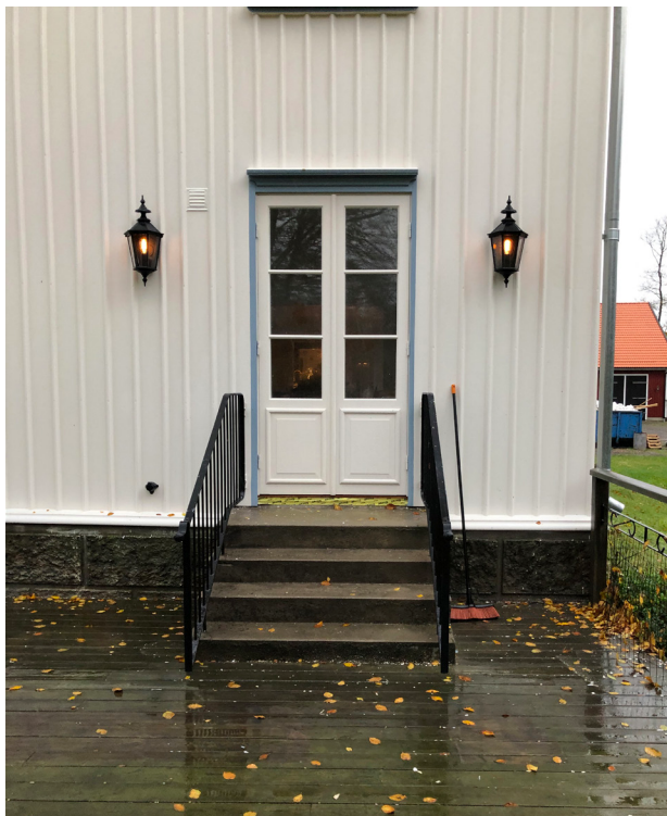
Altandörrarna har ersatts av nya då de befintliga var i dåligt skick.
