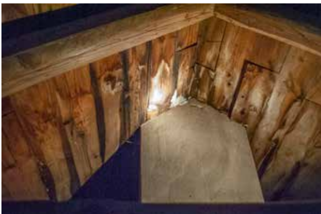
Fuktskadade undertaksbrädor vid murstocken.
