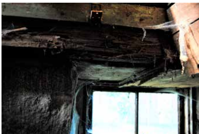
Rötskadad bjälke i källaren.
