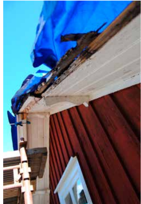
Gaveltaksprånget med panel och taktassar krävde en del översyn.
