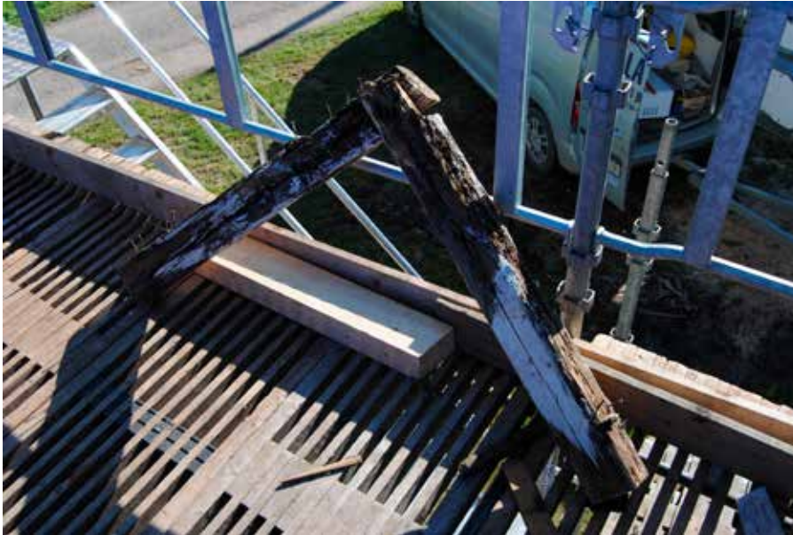
Nedtagen rötskadad del av takstolen från sydöstra gaveln.
