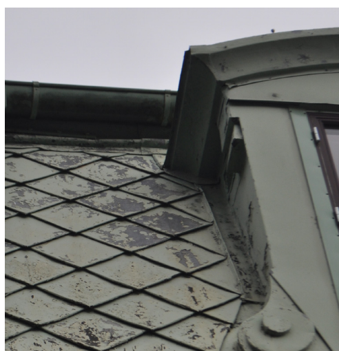
Till vänster syns svarta färgfragment på sidan av takkupan. På takytan till höger framträder två gröna färgskikt och under dessa svarta fragment samt zinkplåtens silvergrå yta.
