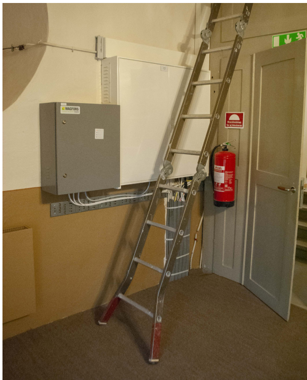
På läktaren, på södra sidan av orgeln, i ett mer undanskynt läge sitter bl.a. nödljuscentralen.
