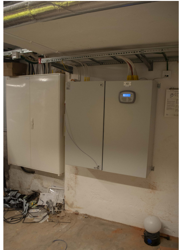
Styrcentraler mm har placerats i källaren.
