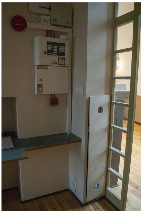
Olika elcentraler och moderna installationer har placerats i dolda lägen, som här i rummet bakom altarruppsatsen. Även i det lilla skåpet i väggen finns en del av ljudanläggningen.
