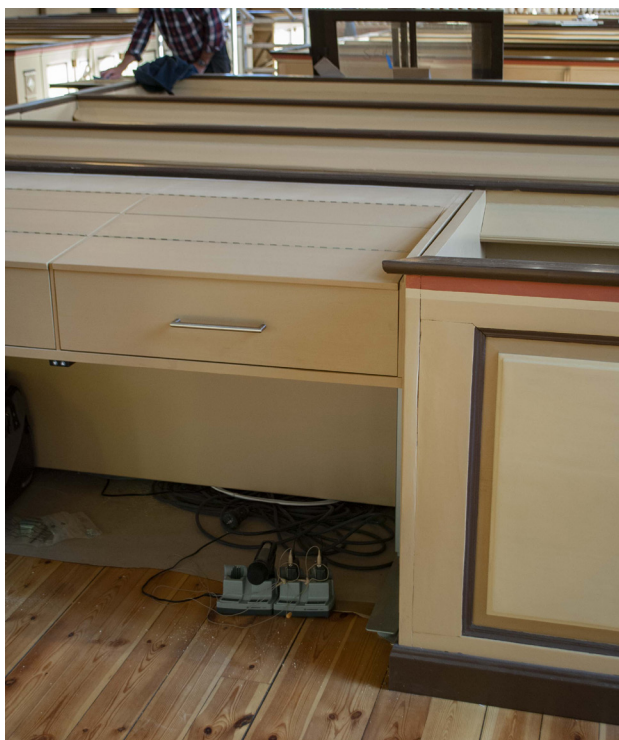
Den nya mixer- och manövermöbeln i nedhissat läge och stängd jalousi. Kablar mm kommer vara mer dolda när allt är färdigställt.
