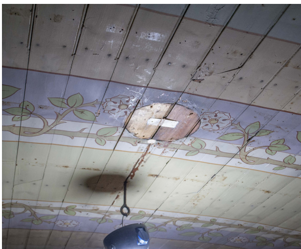
Större hål, som de där takkronorna tidigare suttit har lagats i med trä.
