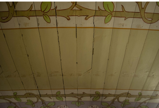
Det har även uppstått lite sprickor mellan brädorna.
