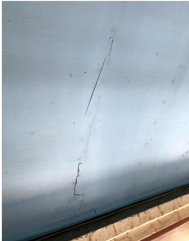
Exempel på sprickor och skador på det nuvarande taket.
