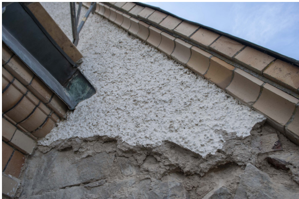
Putsen togs ned. Här en bit av den äldre putsen som sparats på en gavel mot öster.
