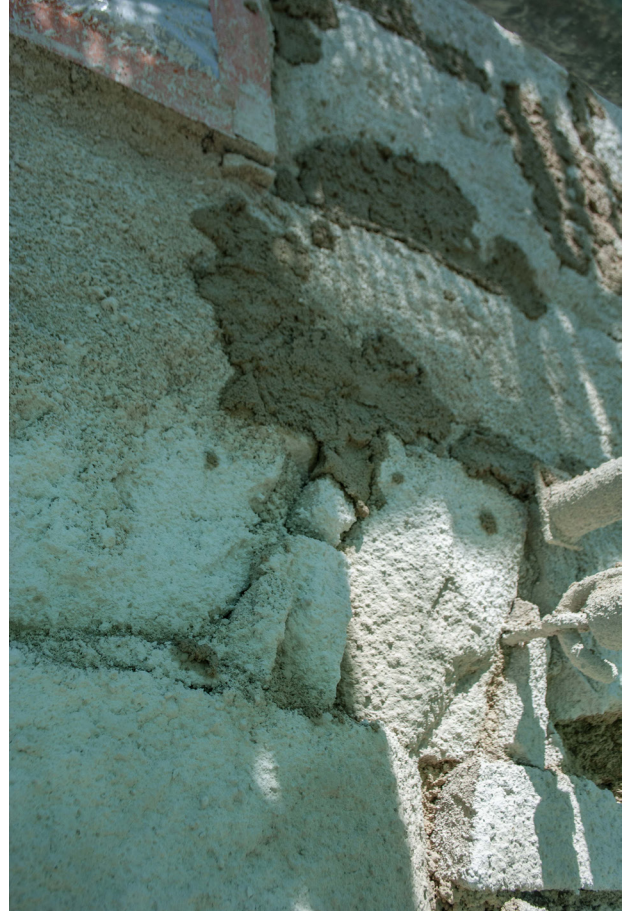
På en del ställen har tjocka lager av bruk fått läggas för att utjämna större sprickor och nivåskillnader i murarna.
