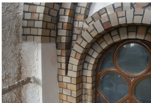
Trasiga stenar har fått bytas till nya i några olika kulörer.
