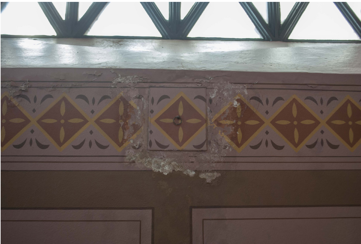
Saltskador på väggen under fönster i koret mot söder. Skadan här har uppstått runt den lilla lådan som ska samla kondensvatten från fönstret.
