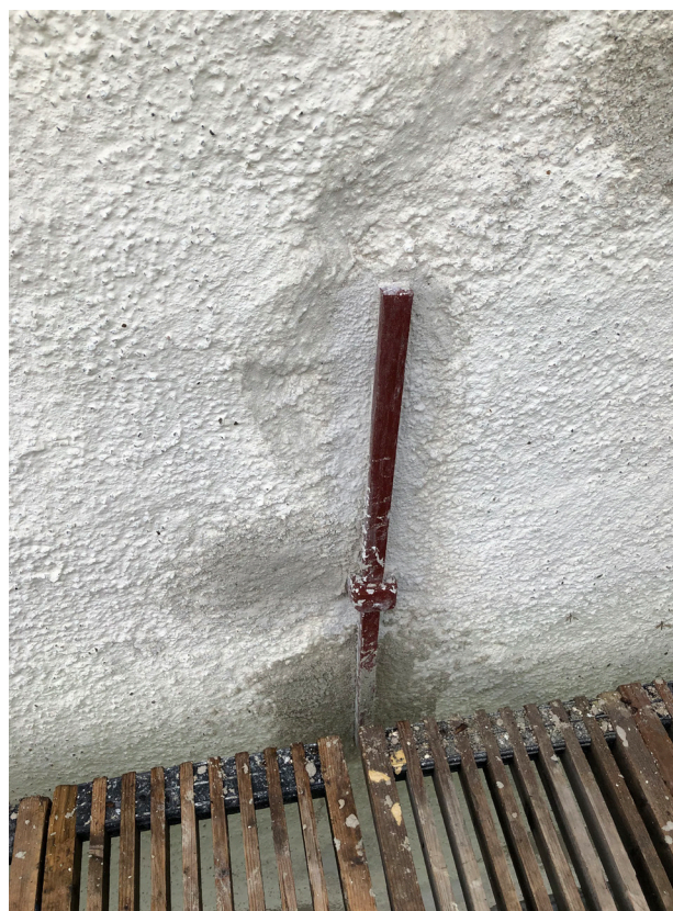
Ankarjärnen hade en del rostskador och har rengjorts och rostskyddsbehandlats.
