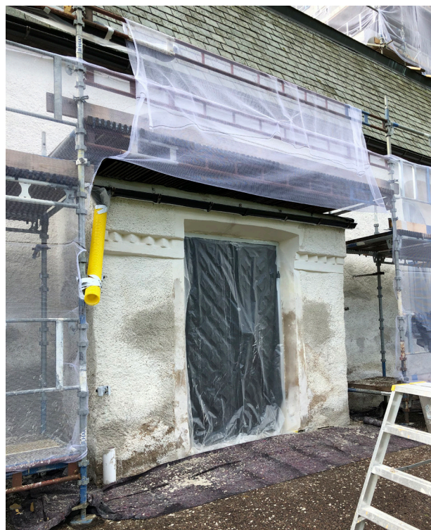
Putsskador fanns runt norra sidoentrédörren. Skadorna håller på att lagas med hydrauliskt kalkbruk.
