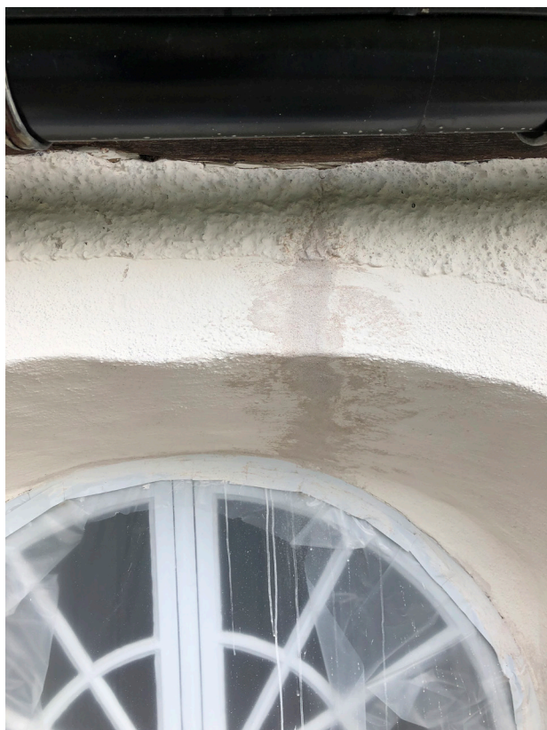
Över flera fönster fanns sprickor som har kratsats ur och putsats igen.
