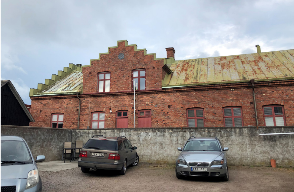
Byggnaden sedd från väster. Här syns de omfattande rostskadorna som fanns på taket före renoveringen.
