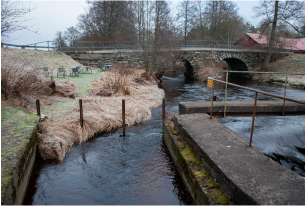
Rännan in till den västra kvarnen är också pågjuten med betong. I intaget står ännu sättrar i järn där dammluckor suttit.
