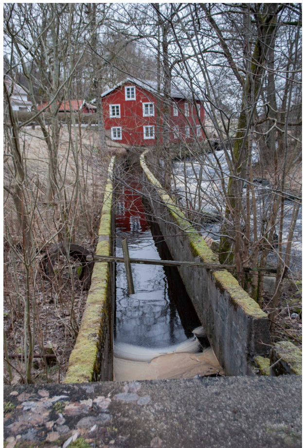
Den gjutna rännan mellan den övre västra kvarnen och den nedbrunna kvarnen/snickerifabriken.
