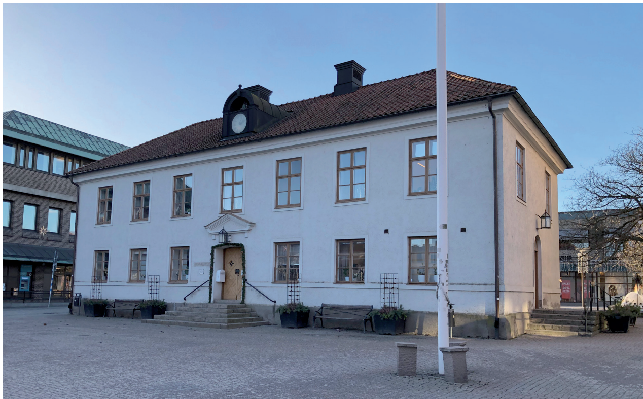
Rådhuset före renovering. Putsen var i relativt gott skick men fasader och tak var nedsmutsade.
