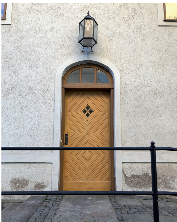
Entré mot söder. Vid sidan om entrén syns slitage i färgen.
