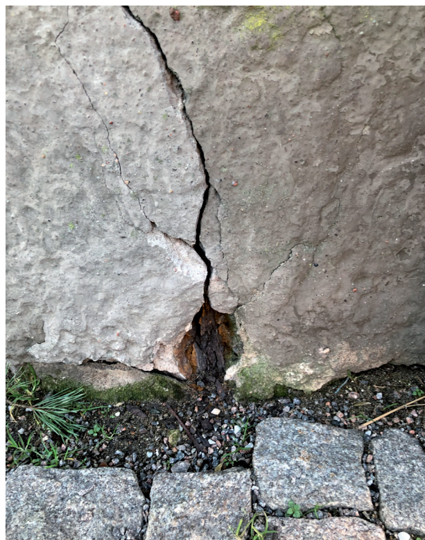
På vissa ställen fanns sprickor i putsen. Här har ett rostande järn orsakat sprickbildning i sockeln.
