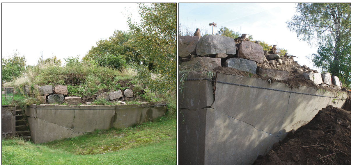
Fig. 3. Stödmuren hölls uppe av en wire samt en grövre järnkätting. Foto: L. Carlie
