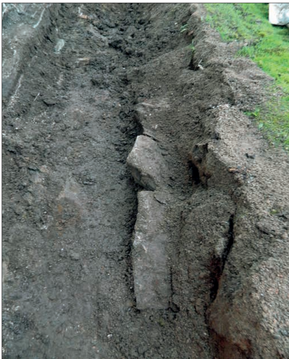
Fig. 10. Stenhällar i schaktet på kyrkans norra sida. Den äldre dräneringen hade dragits mitt genom anläggningen och flera stenar var tydligt rubbade ur sina lägen. Foto: Ing-Marie Nilsson, (Fotonr 2015-5-39).
