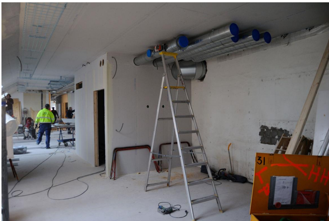
Omfattande ventilationsinstallationer i blivande köksutrymme.
