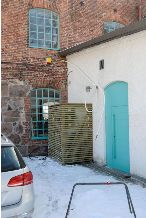
Den nya luftvärmepumpen i nordväst.
