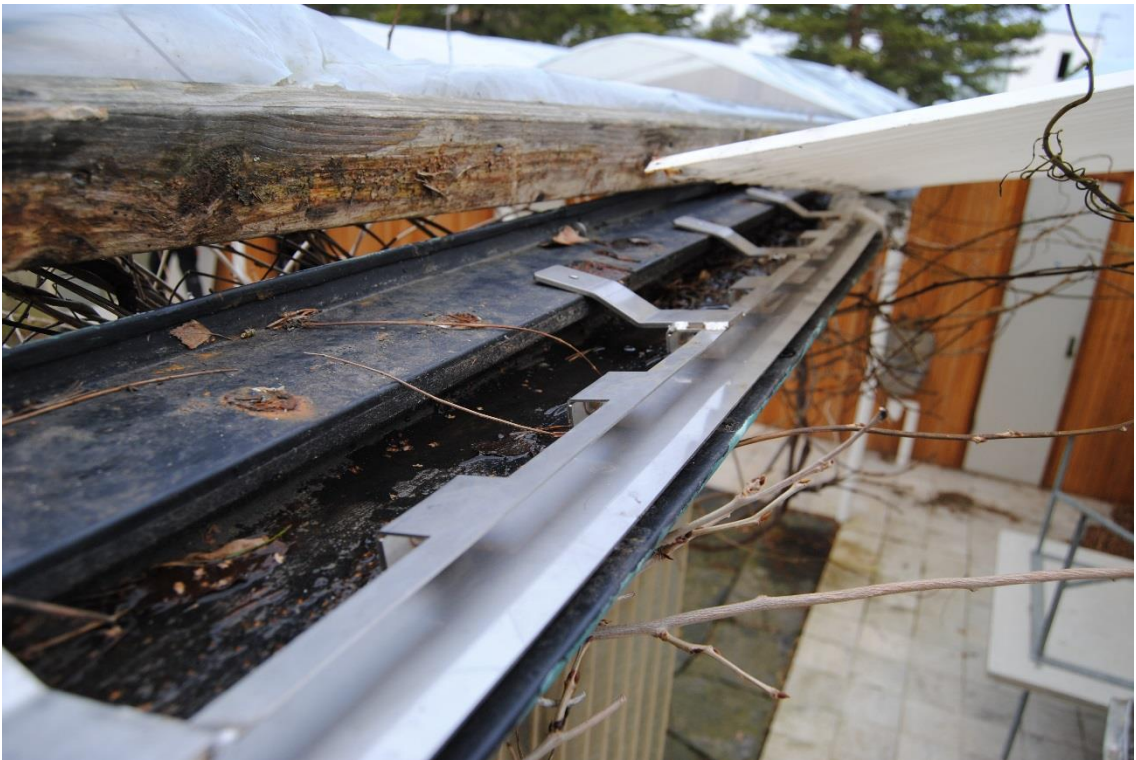
Den nya infästningen klarar av att hålla de nya styvare takskivorna på plats, enligt bedömning också vid stark vind.
