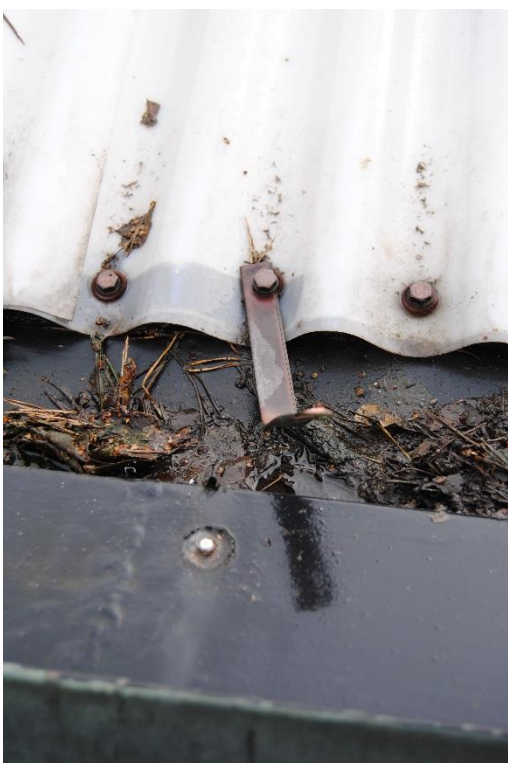
Skruv har gått av och fästet skadats.
