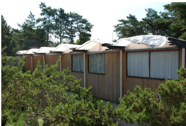
Huset från norr med det förstörda taket, juli 2013.
