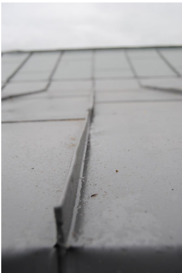
Fals på södra sidans takkupa.
