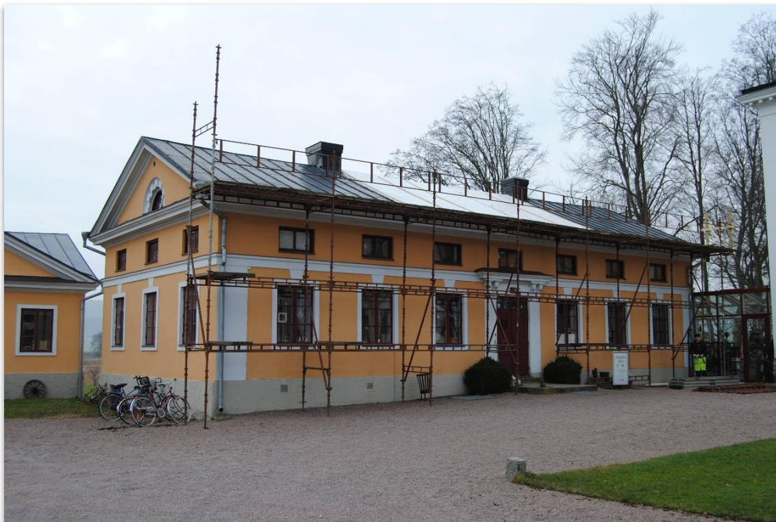
Södra flygelbyggnaden med det skadade taket tillfälligt övertäckt, mars 2014.
