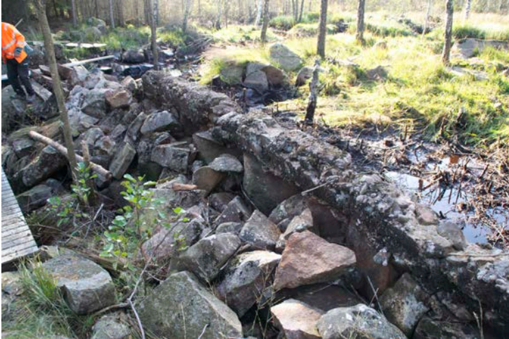
Den raserade dammvallen, med nedfallna stenar och vittrande rester av betong.
