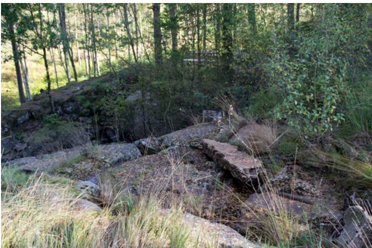
Sten och betongstycken som forslats bort av vattenkraften nedför sluttningen.
