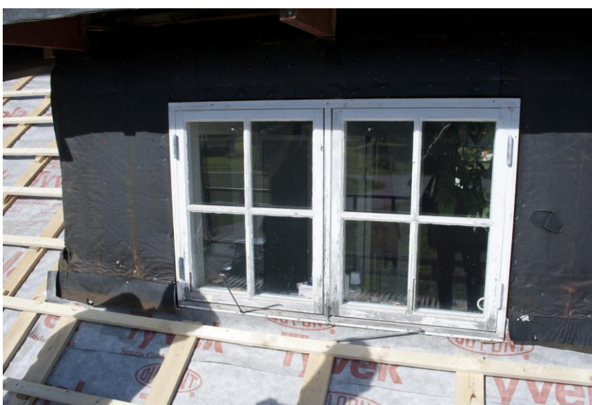
Fönstren i takkuporna mot söder var relativt sentida, troligen 1990-tal. Deras höjd gjorde dock att karmen och bågens nederkant låg precis i höjd med takfallet nedanför.
