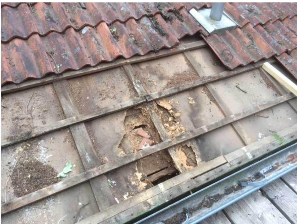
När takpannorna lyftes bort hittades ett hål där regnvatten kunnat tränga in. Foto: Tor-Björn Persson.
