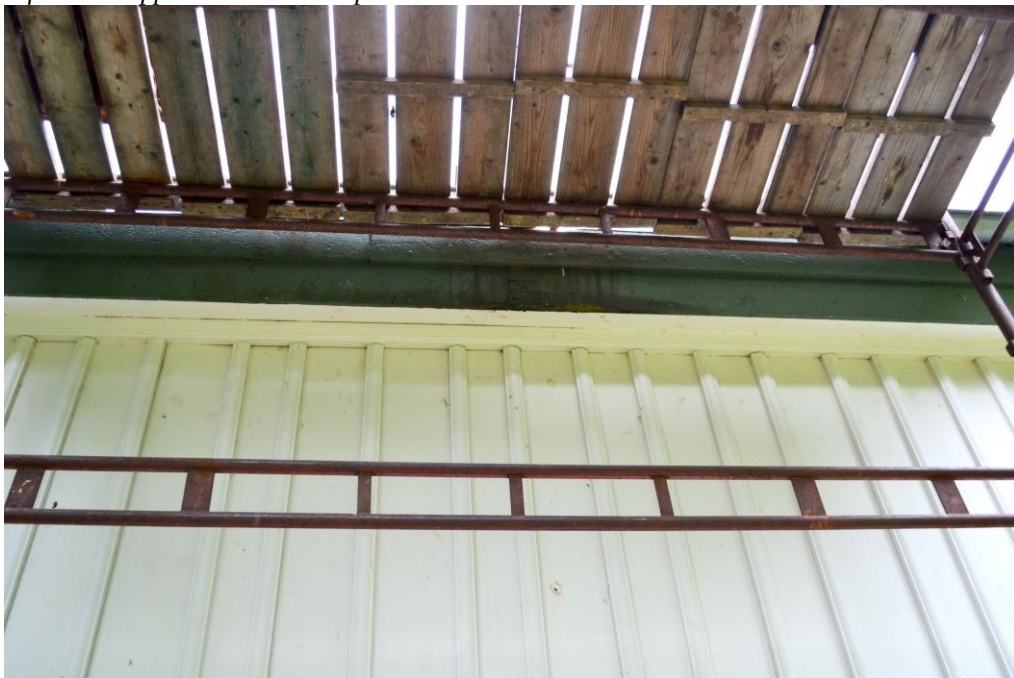
Vindskivan på lutan på norra gaveln visade på fuktskada i taket.
