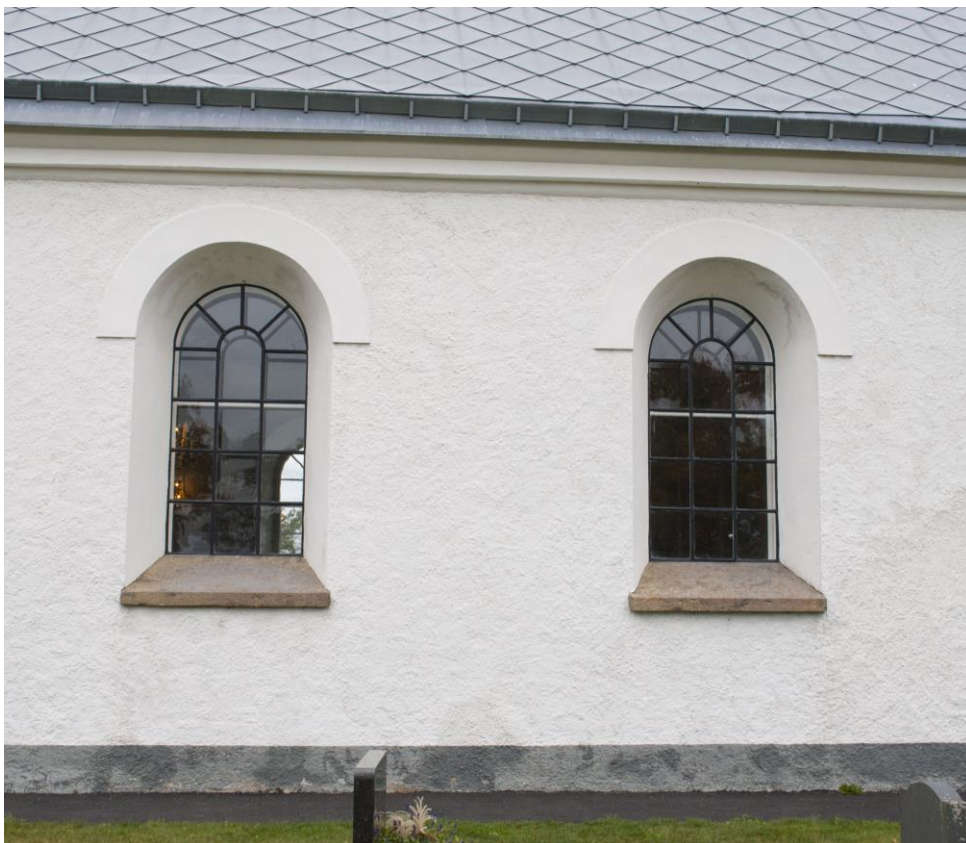
Alla fönster mot söder är nu ommålade. Det kan ännu skönjas mörka skiftningar i putsen runt fönster efter fukt som samlats i murarna efter de läckande fönstren.
