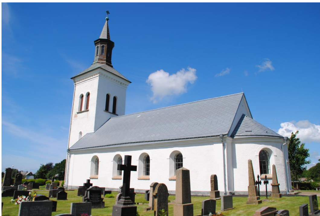
På tornets sydsida skymtar fläckar där putsen fallit bort.
