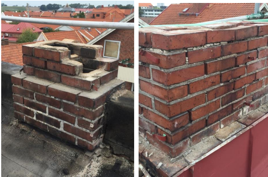
Skorstenarna visade sig vara i mycket dåligt skick då fogarna knappt höll samman tegelstenarna. Foto: Magnus Nord, Erlandssons bygg AB.
