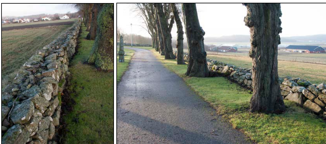
Fyllningen i muren hade sjunkit ihop. Trädkransen intill muren kan ha bidragit till skadorna.
