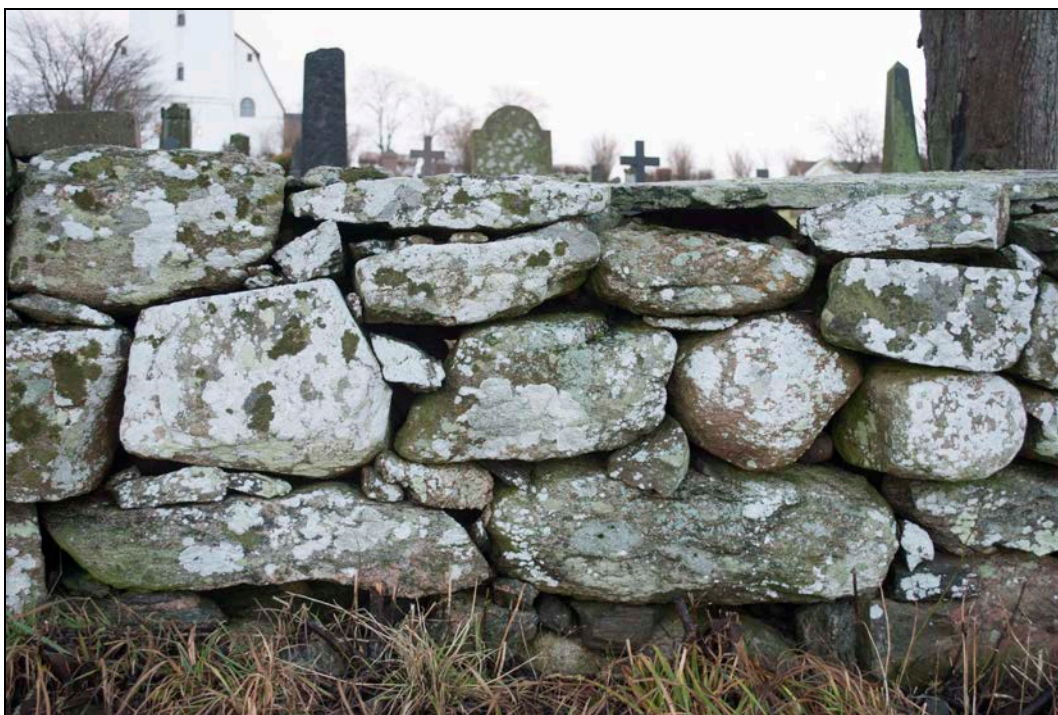
Stenarna i muren har glidit isär.
