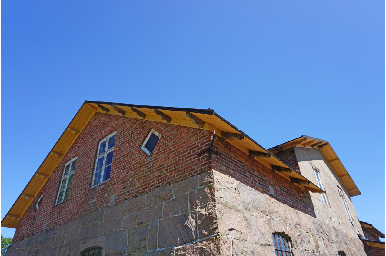
På bilden syns fönster före renovering. Färgen flagade och bågar samt karmar hade rötskade partier.
