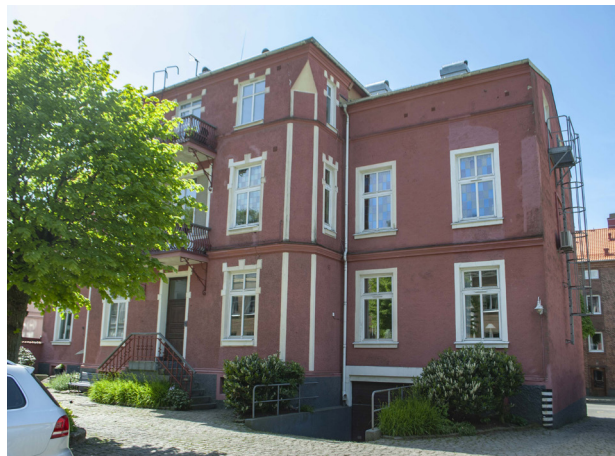
Trapphuset är senare tillbyggt. Fönstren i huset är utbytta och några är igensatta intill balkongdörren på andra våningen.
