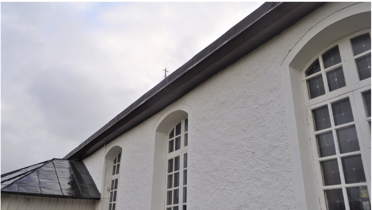
Koppartäckningen går runt taktfoten in mot muren.
