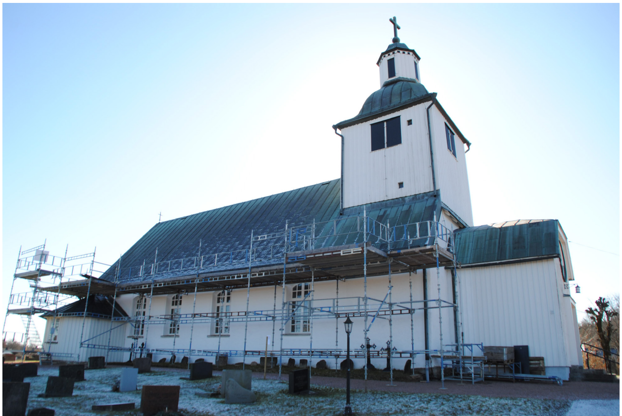
Norra sidan på Kinnareds kyrka, vid renoveringens start. För att försäkra sig om att det inte finns mer skador längs takfoten behöver öppningar göras längs hela takfoten på norra sidan.
