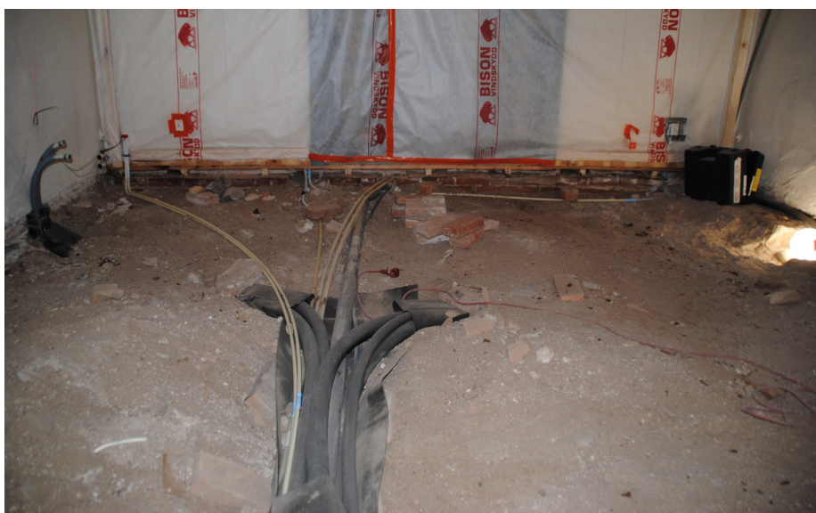
På södra sidan delas rören för att gå till radiatorer på sydöstra respektive sydvästra långhusväggen samt rakt fram till sakristian.
