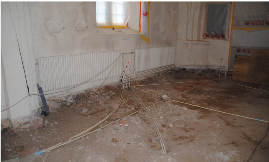
Elledningar på norra sidan i koret.
