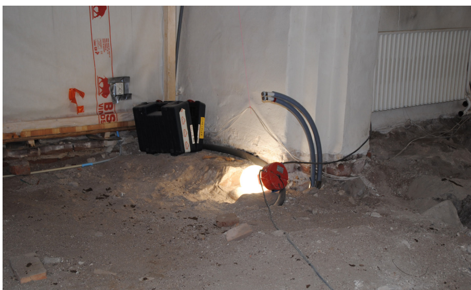
Rören till radiatorerna på sydvästra långhusväggen kommer upp intill valvbågen. Rören fick dras så nära som möjligt, gå grundstenar sticker ut under murarna. De utstickande grundstenarna gjorde de omöjligt att dra rören i marken intill murarna. Risken för läckage i golvet är dessutom mindre när så lite rör som möjligt dras i golvet.
