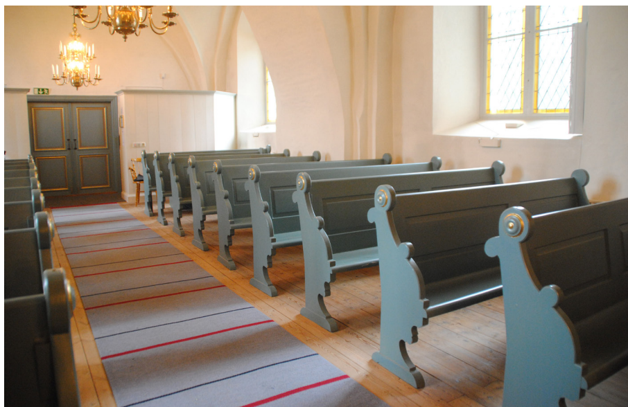
Nordvästra bänkkvarteret innan renovering. Här var golvet så dåligt att det gick att trampa igenom det när bänkarna var borttagna.
