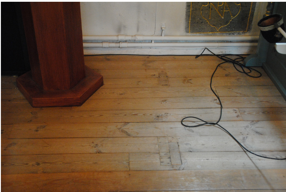
Det fanns gamla lagningar i trägolvet efter tidigare ändringar av inredningen.
