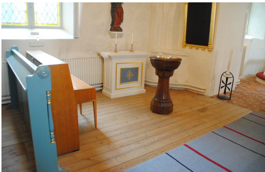
Golvet i nordost längst fram vid dopfont och dopaltare. Trägolvet hade varit så dåligt vid tidigare tillfälle att delar av det var bytt.
