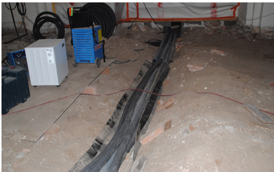
Värmerören har dragits från källaren i den norra korsarmen rakt över kyrkan i tvärgångens läge.
