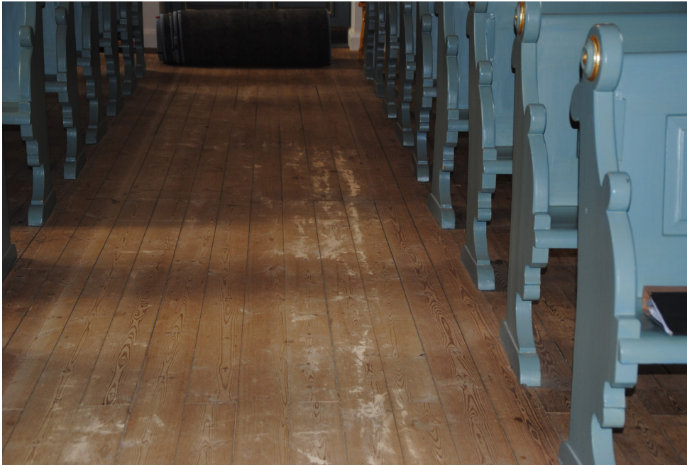
När mattan i mittgången lyftes bort fanns tydliga spår av trägnagarna i form av rikliga mängder trämjöl.
