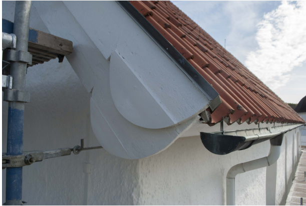
De dekorativa rundningarna i änden av den södra vindskivan mot väster var rötskadad. Skadan togs bort och ersattes med friskt trä.
