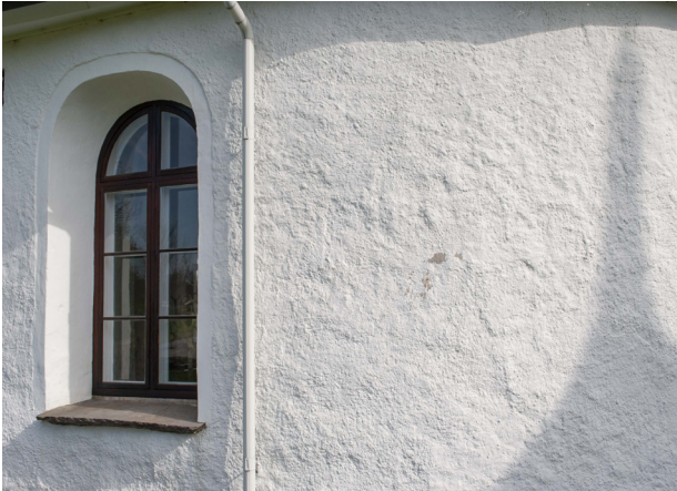
En skada på putsen mitt på väggen vid korets södra sida.
