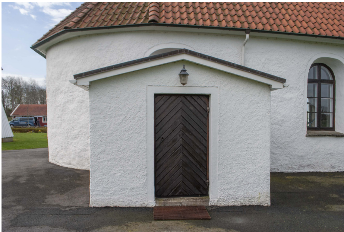
Ingången till sakristian innan åtgärd. Överlag var kyrkan i gott skick men med viss smuts och små skador längst ned på fasaden mot marken.
