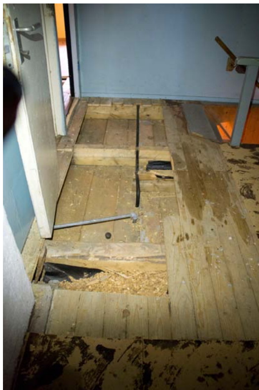
Uppbrutna golv på andra våningen efter vattenskada.
