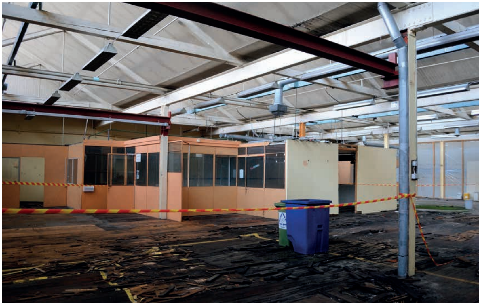
I den stora fabrikslokalen har ett flertal mindre rumsutrymmen byggts in. Parkettgolvet är idag svårt fuktskadat.
