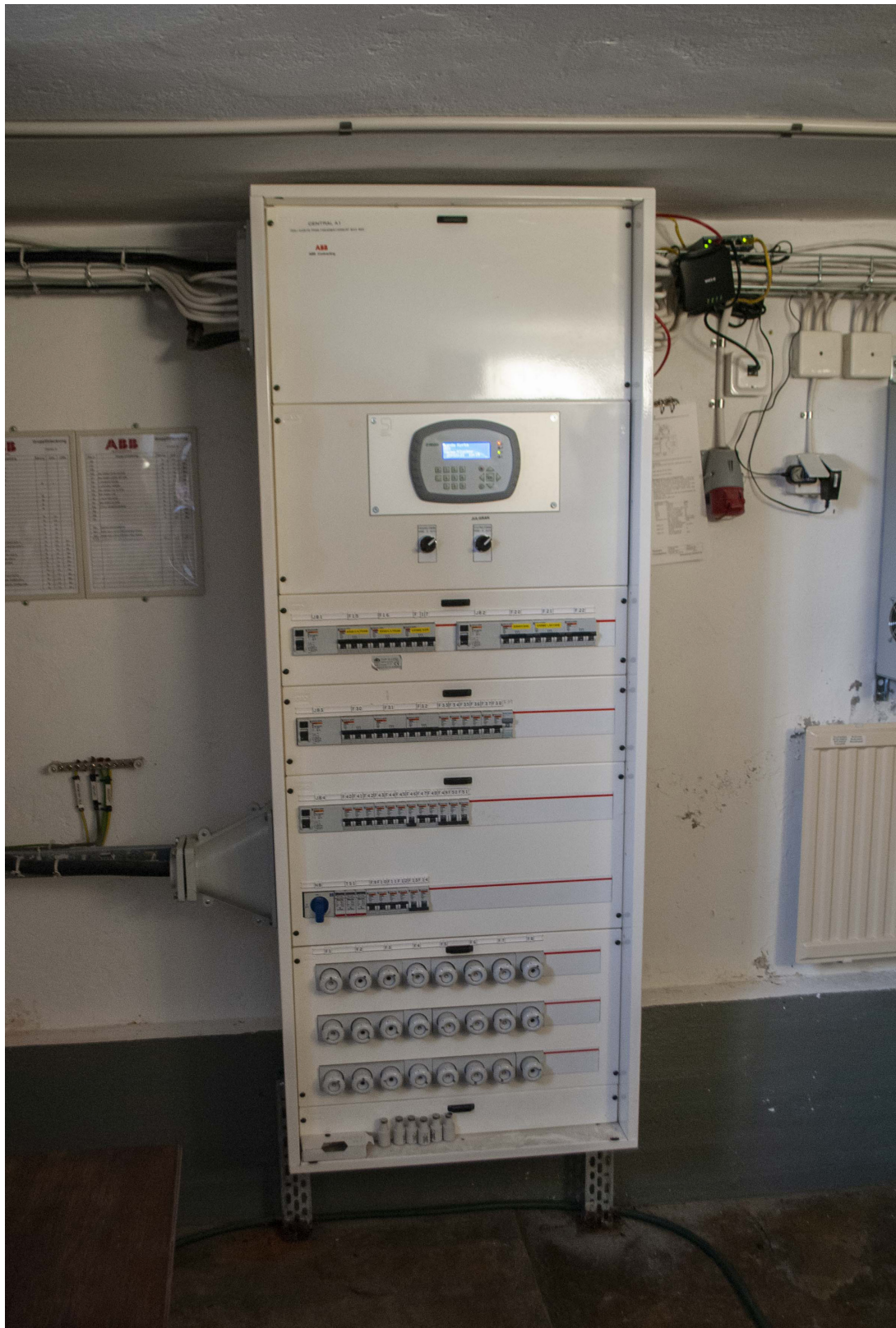
Datacentralen (DUC) är placerad i källaren under sakristian.
