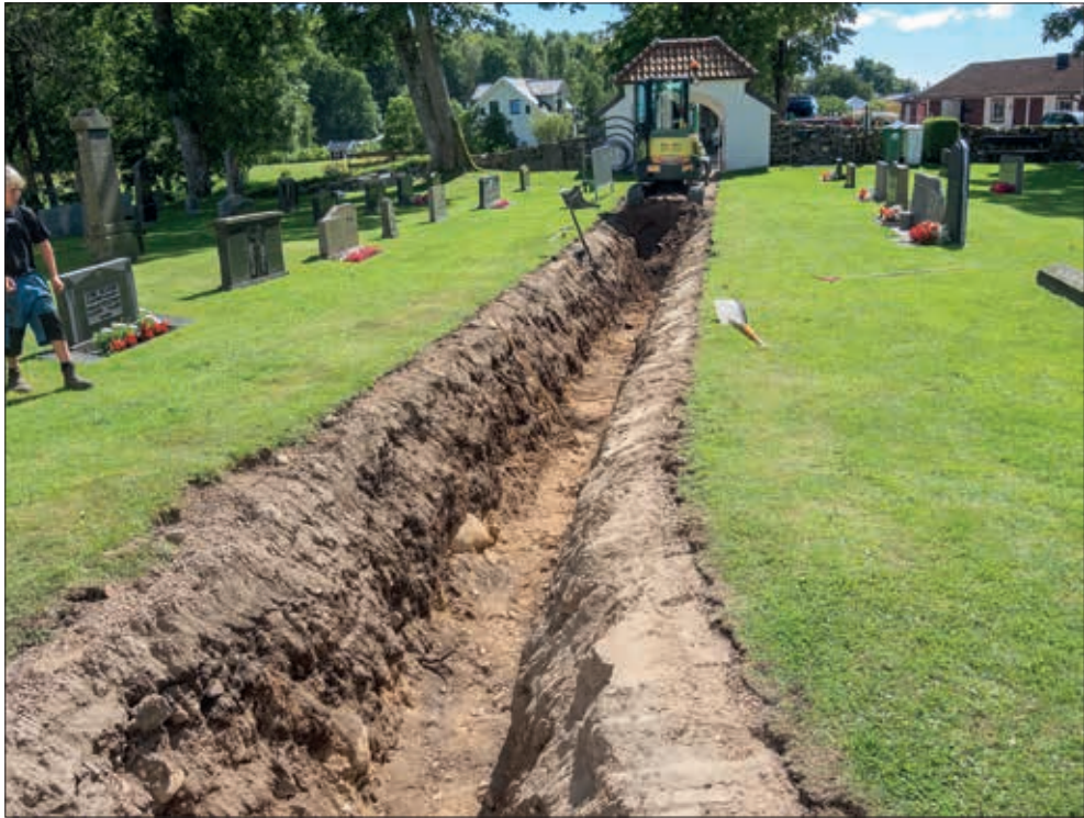
Fig. 6. Schakt 2 söder om kyrkan i den befintliga grusgången. Nedgrävningar för gravar syns i hela schaktet. Mot S. Fotonr 2015-43-19. Foto:Stina Tegnhed
