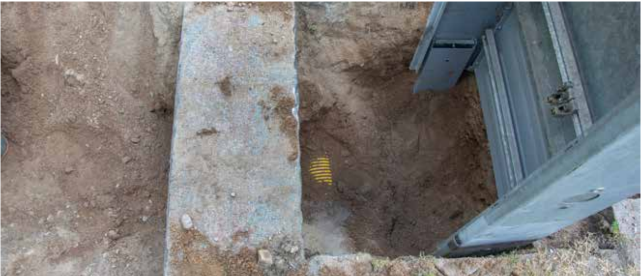
Figur 4. Elskåpet på plats i schaktets östra del. Från väster. (Fotonr. 2021-56-4). Foto: Sofie Renström.
